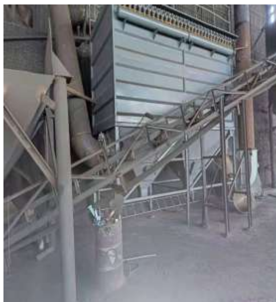
图 4-8 2#钛中矿烘干布袋除尘器
