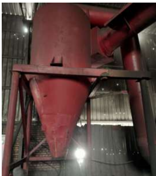
图 4-7 1#钛中矿烘干旋风除尘器
