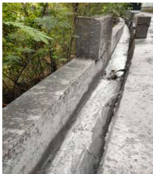
图 4-5 废水收集地沟
