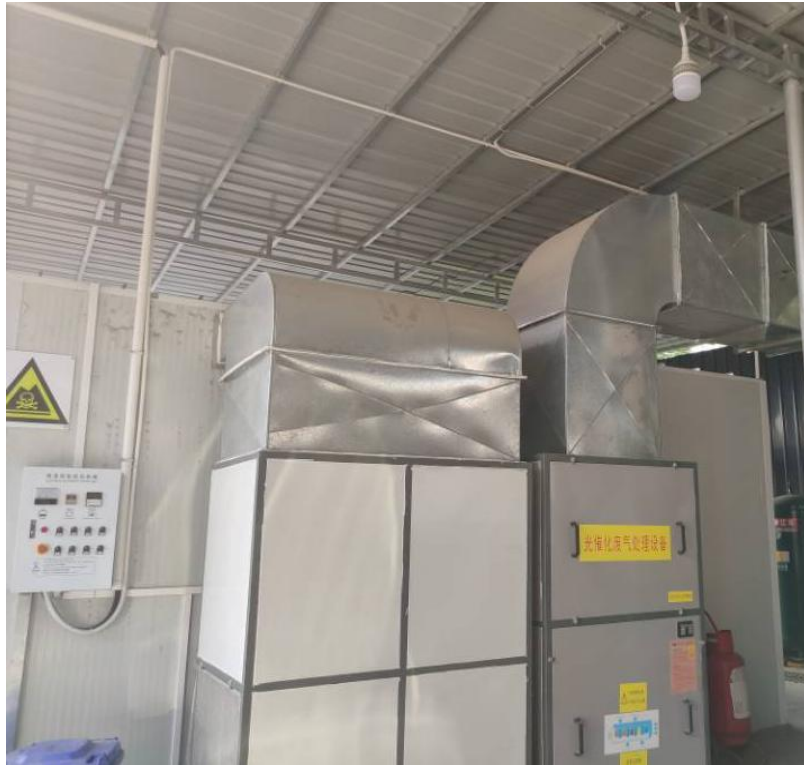
图 3-2 喷烤漆废气处理设施
