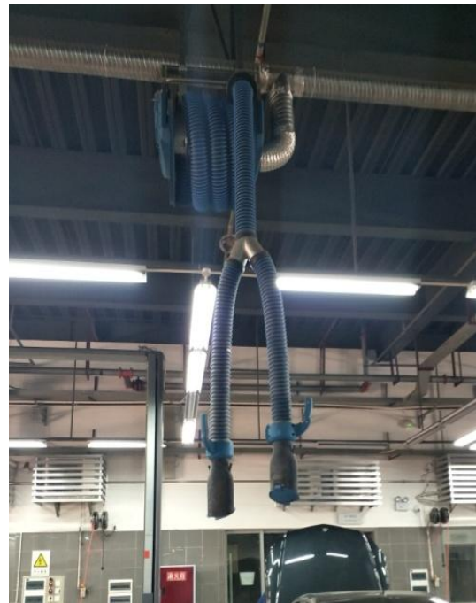
滑轨式汽车尾气抽排系统
