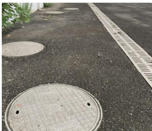
雨水收集地沟
