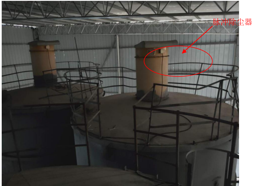
图 3-4 粉料仓及脉冲除尘器
